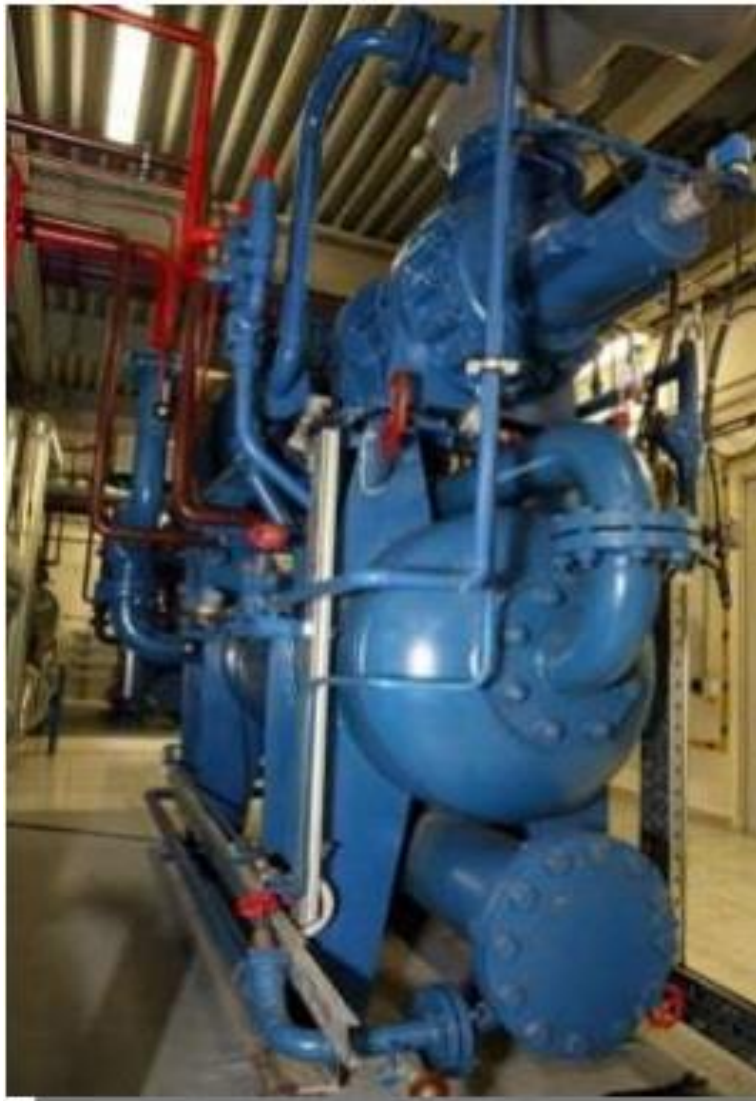
Рисунок 4.3. Загальний вигляд трубопроводів холодильного обладнання для об'єктів заморожування м'ясних продуктів та компресорної установки
